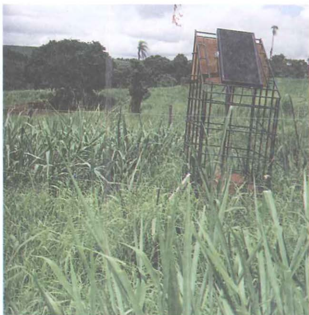
Foto 37 Los energizadores con placa solar y las baterías, además de una buena toma de tierra, necesitan ser protegidos contra daños cuando están colocados lejos de las casas.
